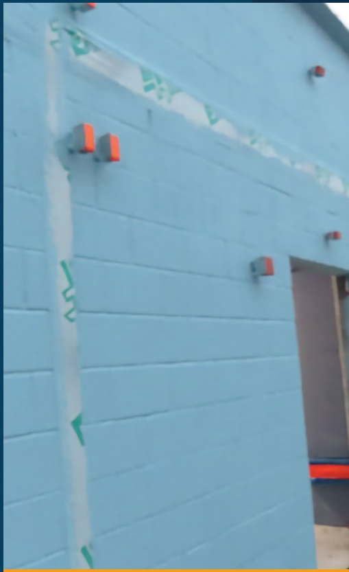
Instalación de AVB líquido y pelar y pegar en paredes de CMU
